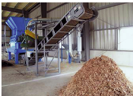
▲破碎プラント
